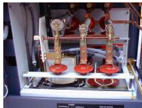
Sectionneur arrivée équipé de fusibles HPC et d'un transformateur d'auxiliaire
